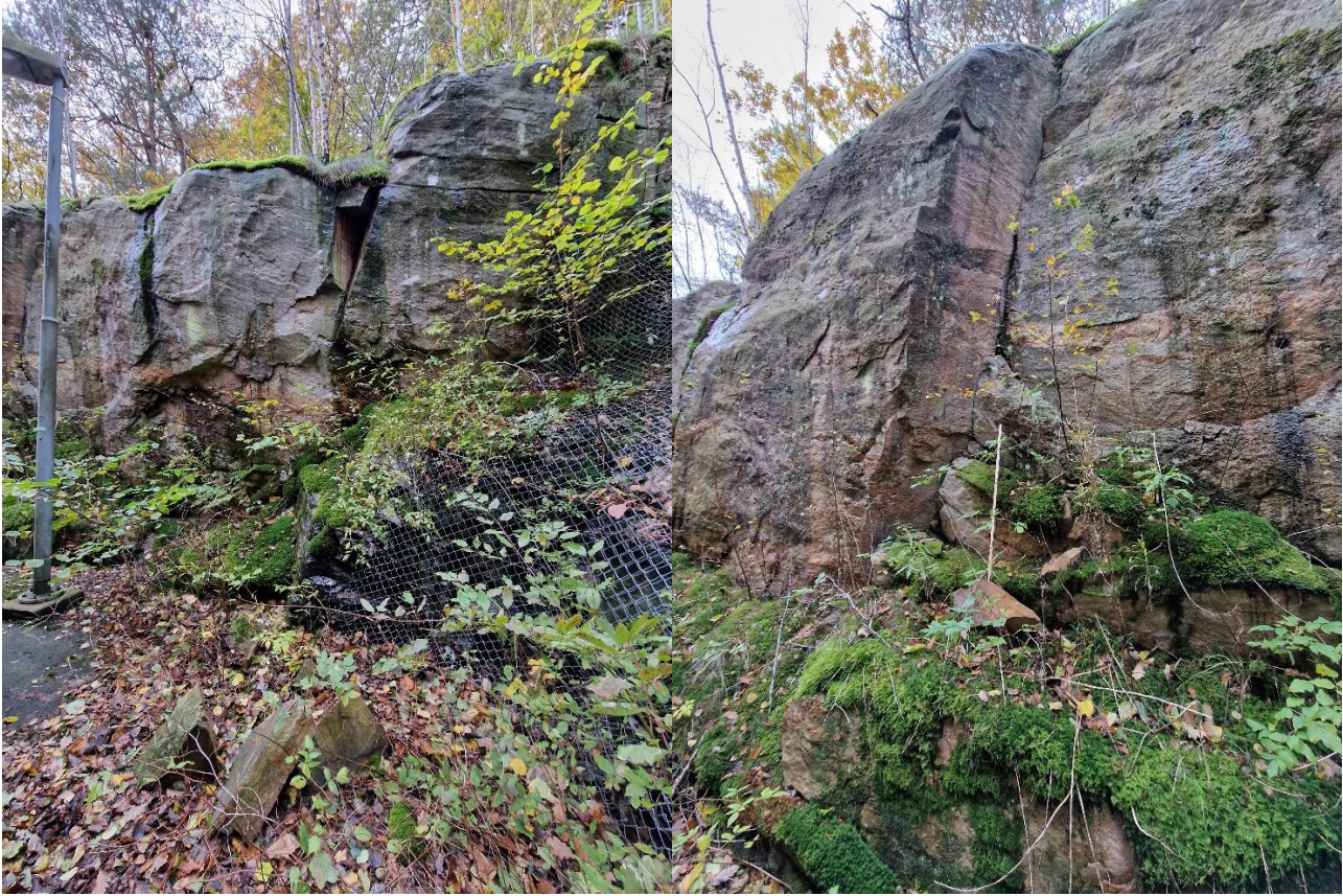
Figur 3 Fotografier av blockutfall i den befintliga släntens norra del. Utfallet till vänster är kilformat. Se skada 2 och 3 i figur 8.
