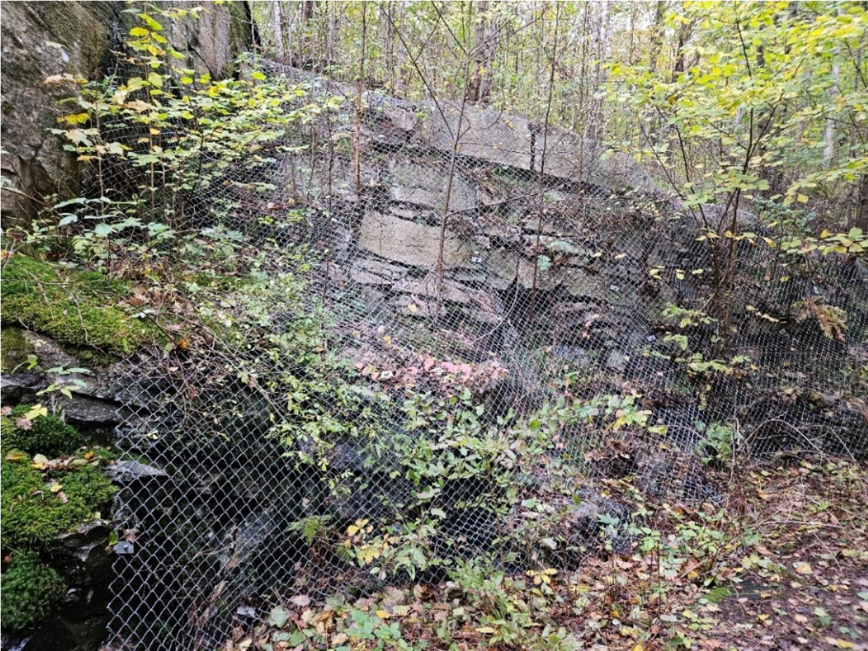
Figur 2 Fotografi av Gunnebo-bergnät i norra delen av den befintliga slänten. Vegetation bakom nätet kan komma att påverka bergskvilltet och nätets funktion i framtiden. Se skada 1 i figur 8.
