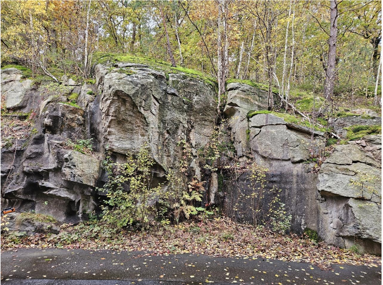
Figur 5 Fotografi av vegetation som har fått fäste i sprickor i den befintliga slänten och som kan komma att påverka bergskvaliteten i framtiden. Se skada 6 i figur 8.
